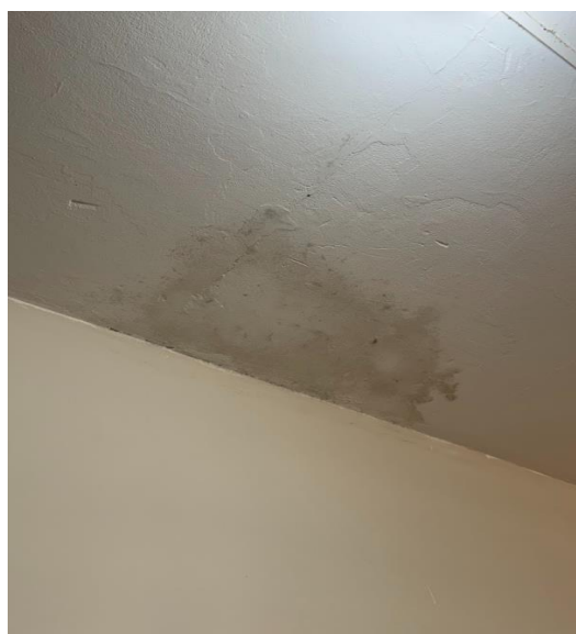
Sinal de infiltração no teto (foto 01).
