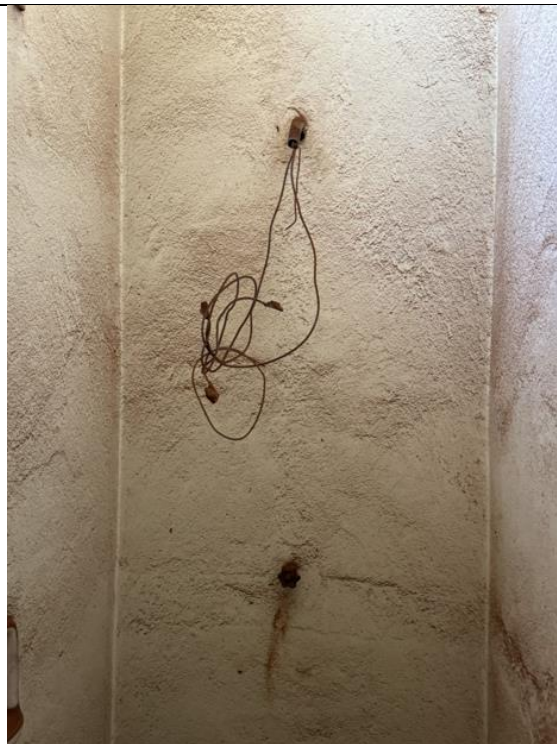
Ausência chuveiro de emergência/lava olhos e de equipamentos de proteção individual no local.
