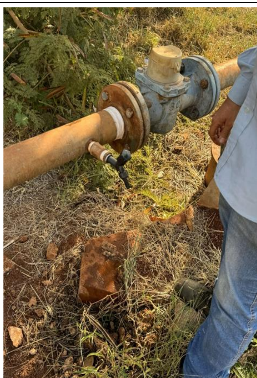
Torneira apresentava vazamentos.
