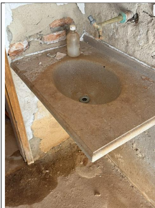
Sujidade no banheiro c/c ausência chuveiro de emergência/lava olhos e de equipamentos de proteção individual no local.
