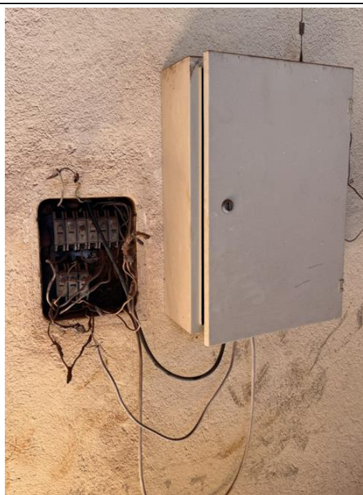
Fios exposto na caixa de energia.
