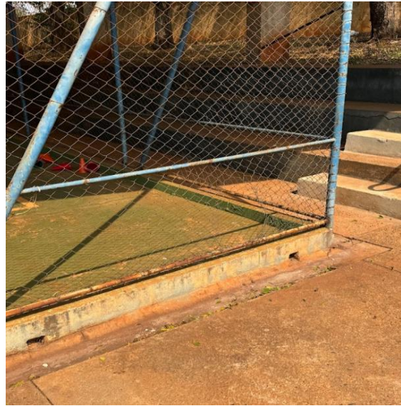
Buracos na grade da quadra.
