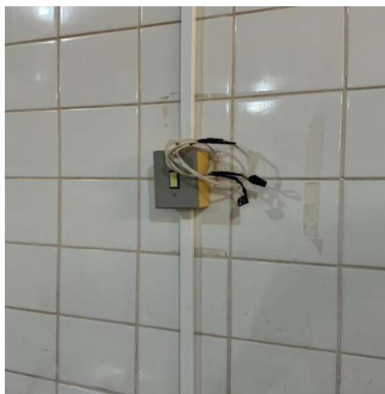
Existência de fiação exposta (foto 04).
