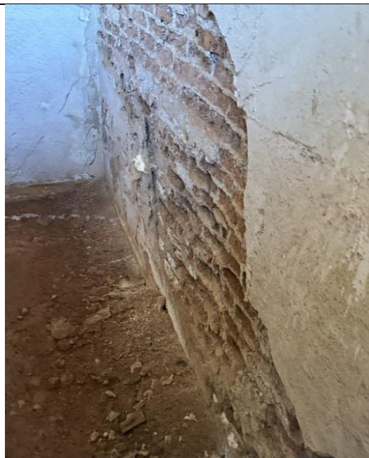
O revestimento da parede estava corroído no abrigo de cloro e flúor.
