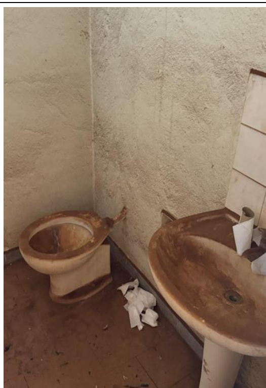
Bastante sujeira nos banheiros.
