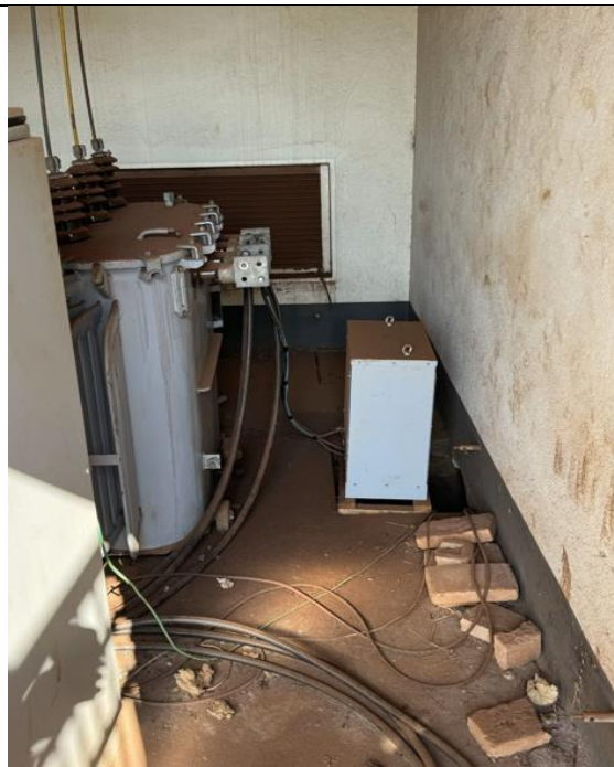
Fios soltos e bastante sujidade no ambiente onde ficam as máquinas de energia.
