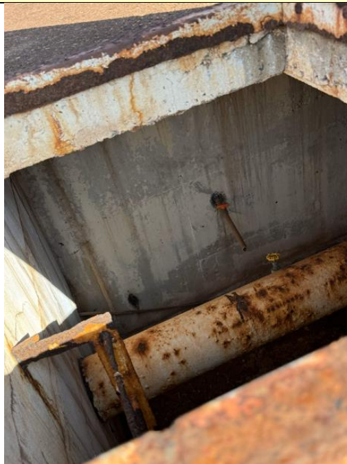
Não tem torneira de coleta de água bruta. Existe um ponto de derivação, localizada dentro da caixa de inspeção.
