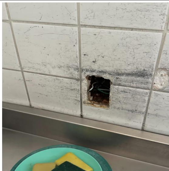
Existência de fiação exposta (foto 02).
