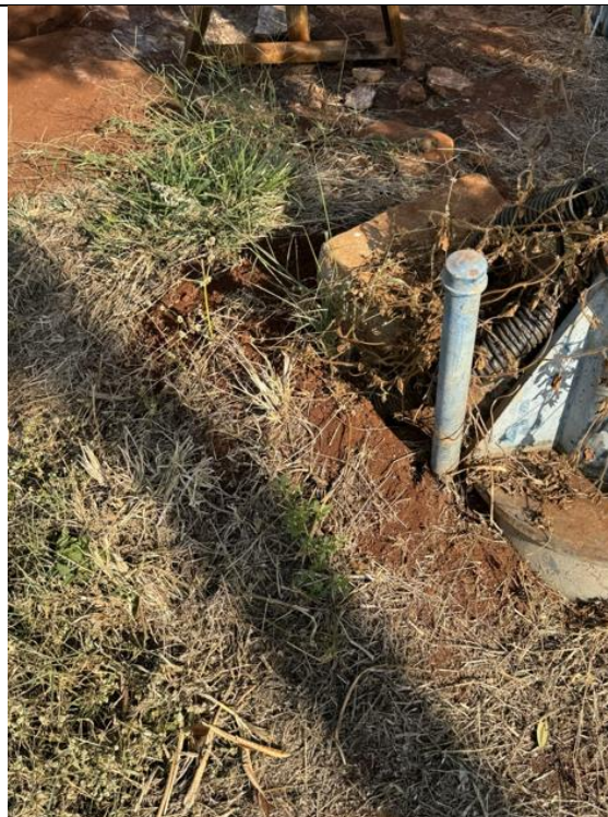
Laje sanitária quebrada e necessitando de limpeza em seu entorno.
