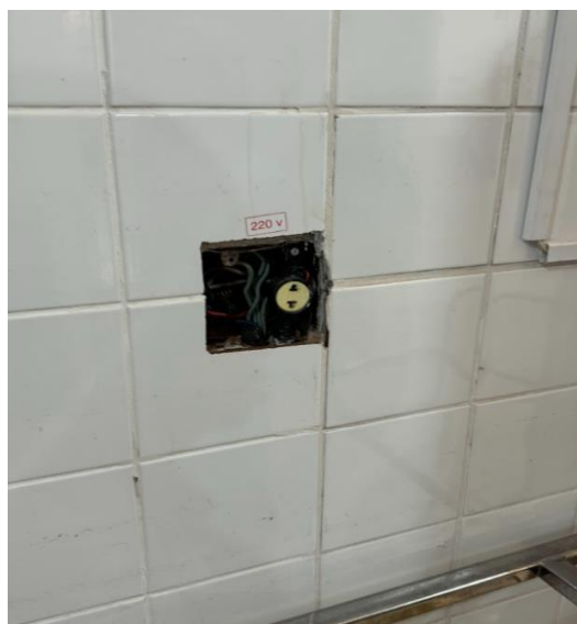
Existência de fiação exposta (foto 03).
