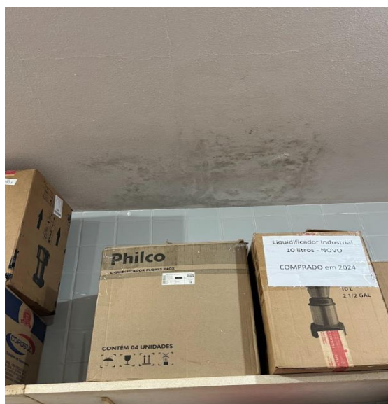
Sinal de infiltração no teto (foto 02).
