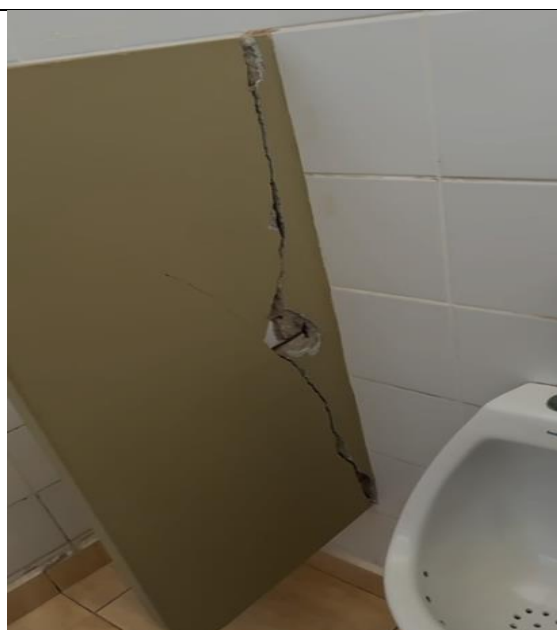
Divisória do banheiro com rachaduras.
