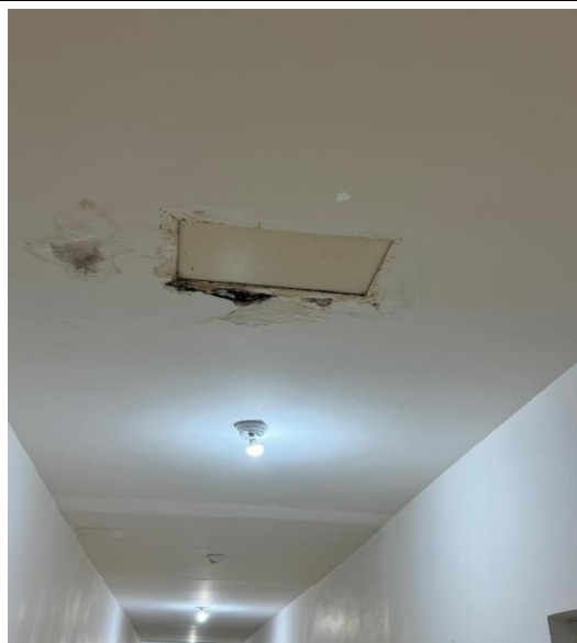
Sinais de infiltrações.
