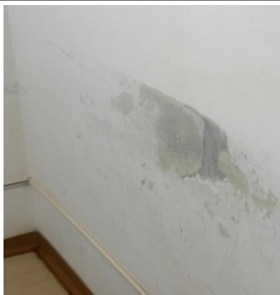
Sinais de infiltrações.
