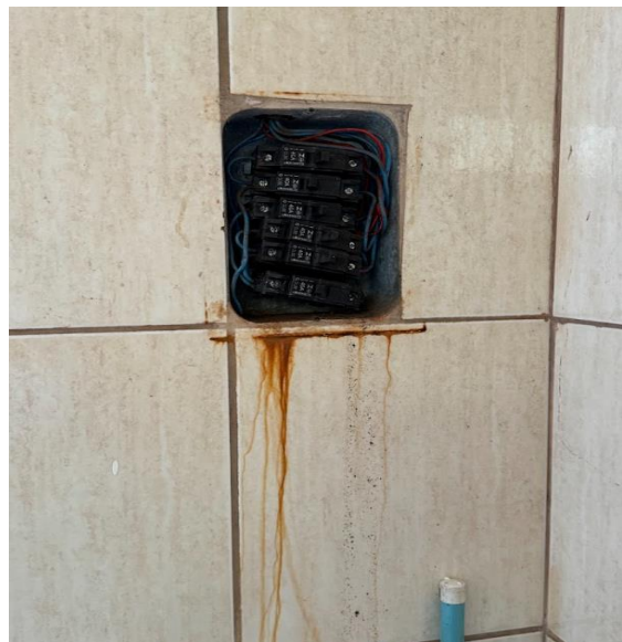
Fios de energia à mostra no banheiro.
