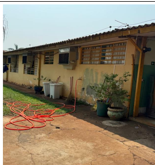
Paredes desgastadas e com infiltrações (foto 01).
