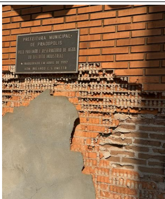
Paredes corroídas na parte externa.
