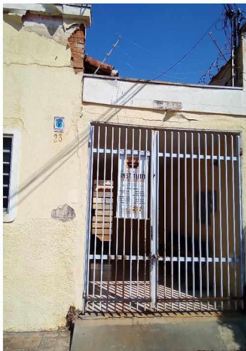
Ausência de nome na fachada.
