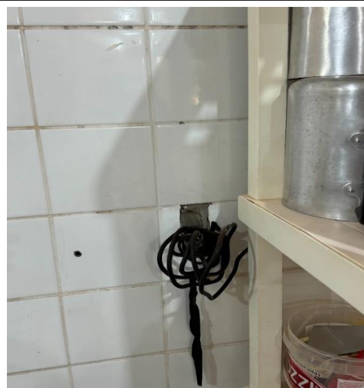
Existência de fiação exposta (foto 01).
