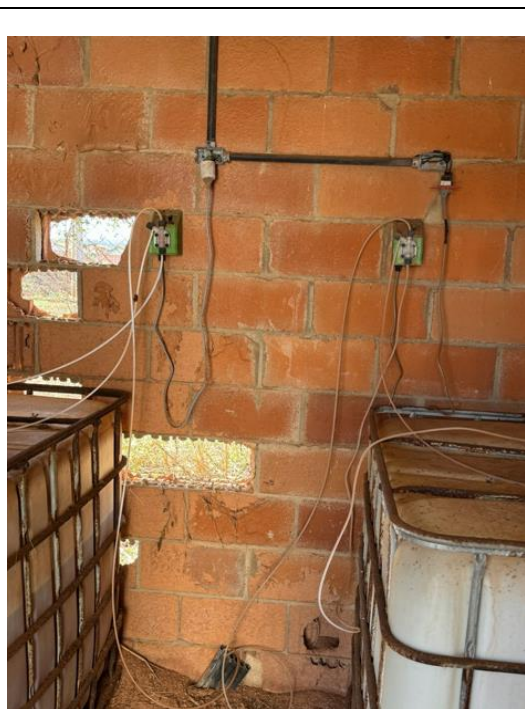
Bastante sujeira nas tampas das bombonas do cloro e flúor e as paredes se encontram corroídas.
