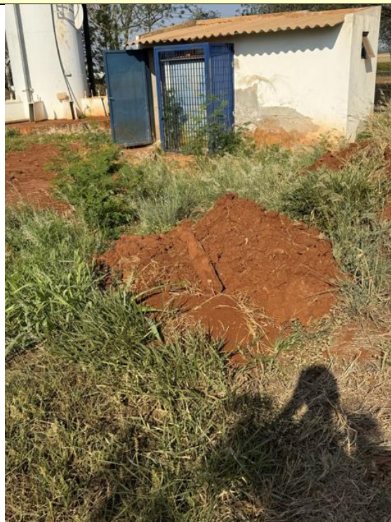
Mato alto e bastante terra acumulada em volta do local.
