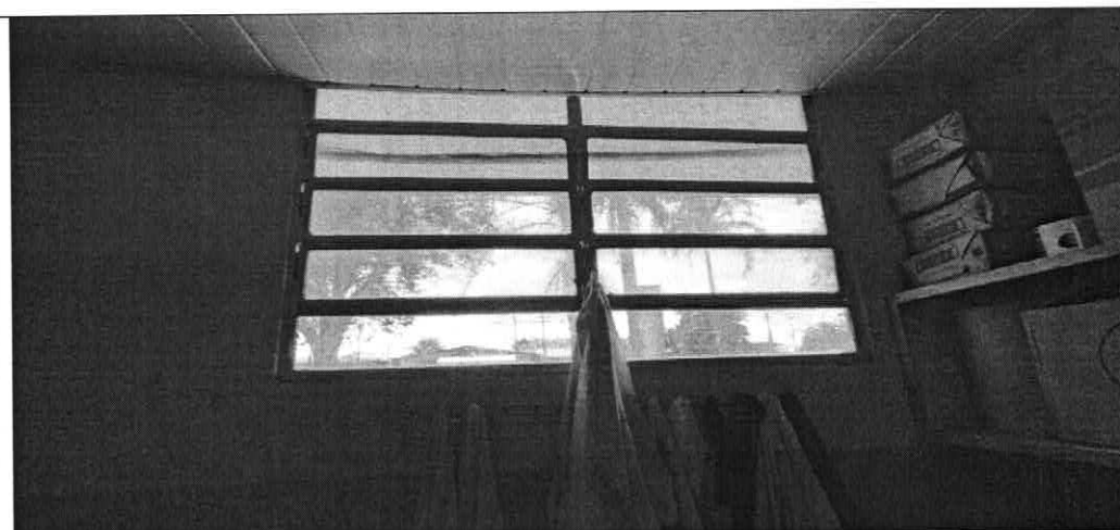
Área de armazenamento de gêneros alimentícios (e outros materiais) sem tela milimetrada na janela
