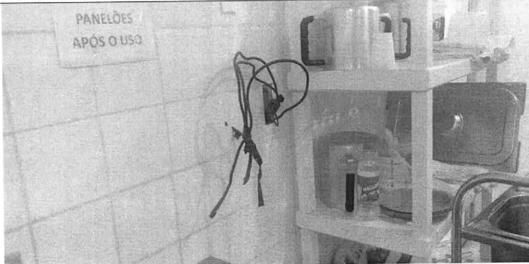
Fiação de energia exposta
