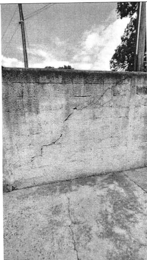
Fissuras no muro
