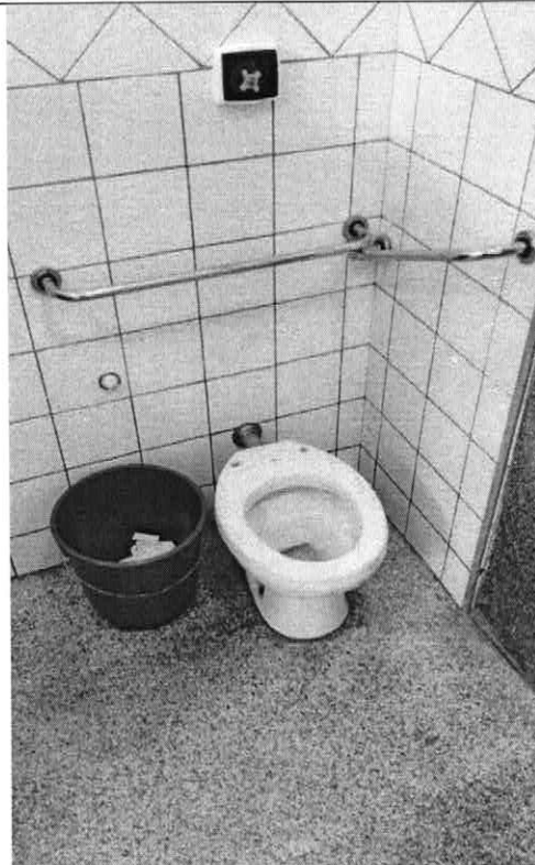
Vaso sanitário sem tampa, válvula de descarga sem proteção e ausência de papelreira
