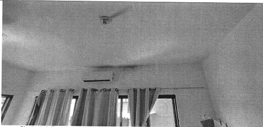
Sinais de infiltração/bolor na parede, lâmpada queimada e ar-condicionado com defeito
