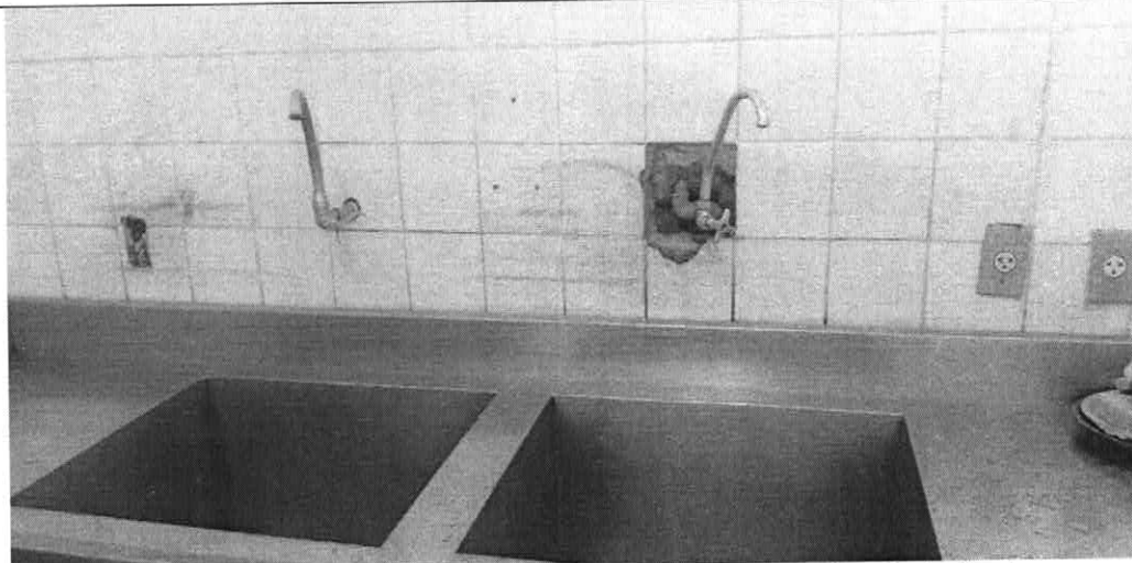
Tomada de energia sem proteção, com fiação exposta e revestimento danificado
