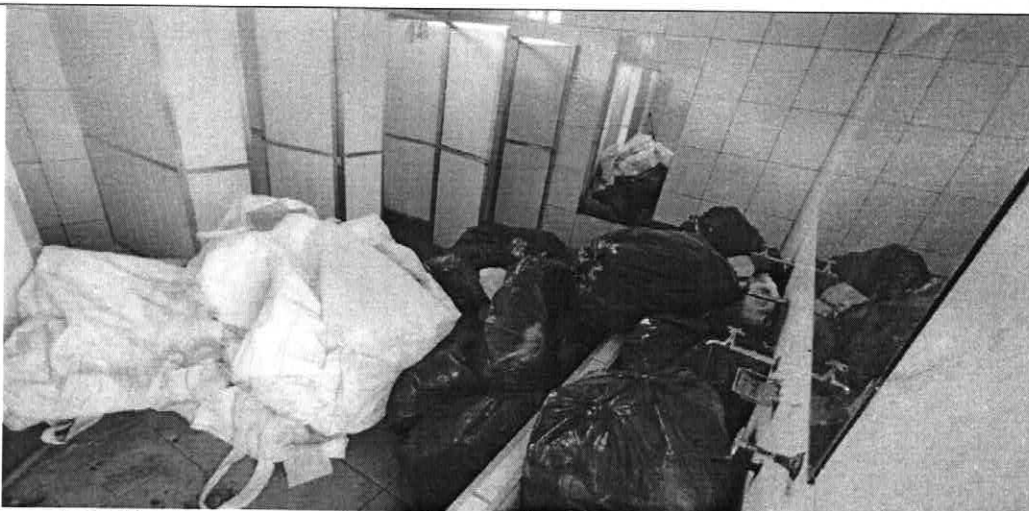
Vestiários da quadra esportiva precários e utilizados para depósito de materiais recicláveis
