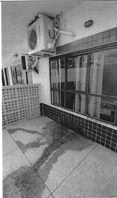
Escoamento de água verificado junto à condensadora de ar, por possível instalação inadequada
