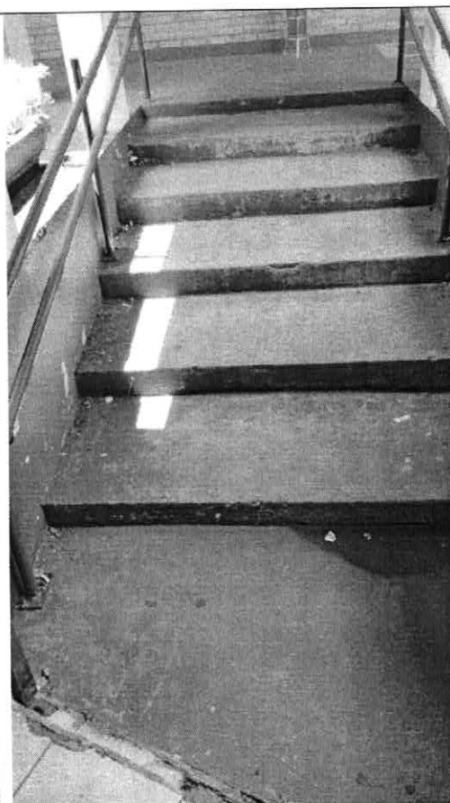
Acesso a bloco com salas de aula unicamente por intermédio de escadaria, revelando falta de acessibilidade
