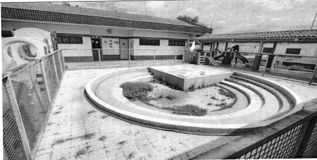
Mal conservação da área externa destinada a atividades artísticas/teatrais
